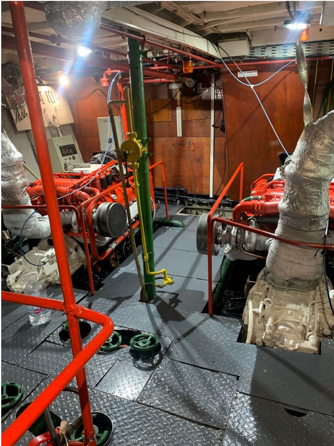
Vista general sala de Máquinas
